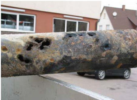
Stark korrodierte Hauptleitung
