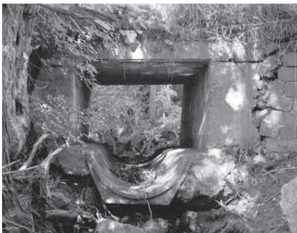
Zu renaturierender Durchlass am Neuhäuser Bach Foto: Margit Riedinger
