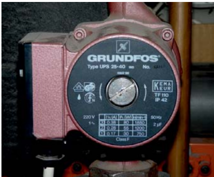
Grundfos Pumpe, Foto: Ulrich Forschner
