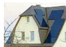
PV-Anlage auf Hausdach.
