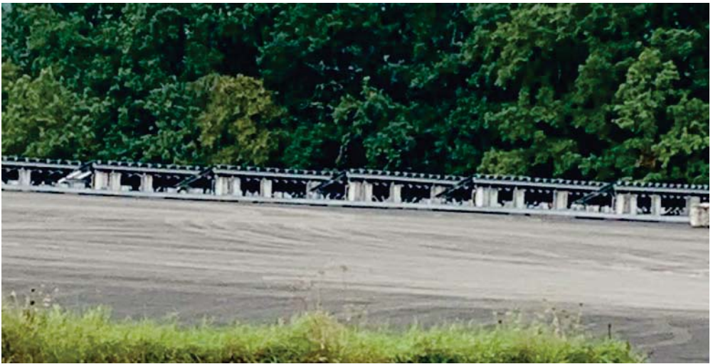
Photovoltaikanlage auf der Deponie Ramsklinge, Foto: Claudia Arold
