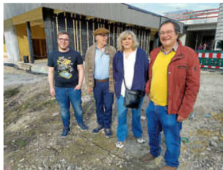
Die Mitglieder der Fraktion DIE GRÜNEN Dominic Dean Haag, Karl-Heinz Ruckgaber, Catherine Kalarrytou, Stefan Zimmermann nach der Besichtigung des Rohbaus.
